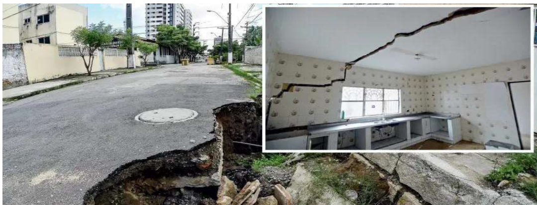
Figura 14 - Bairro afundado pela extração indevida de sal gema em Maceió
